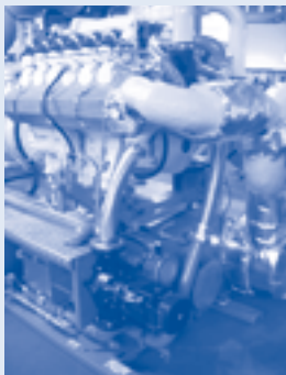
Prämiert: Energiesparen mit dem Brennwert-Blockheizkraftwerk
